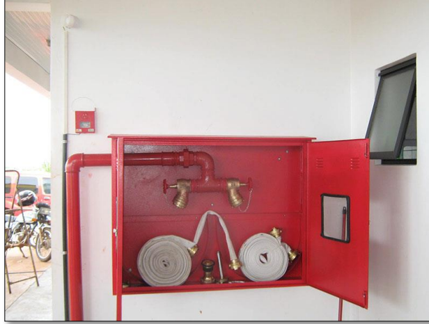
Figura 4: Sistema de hidrantes
