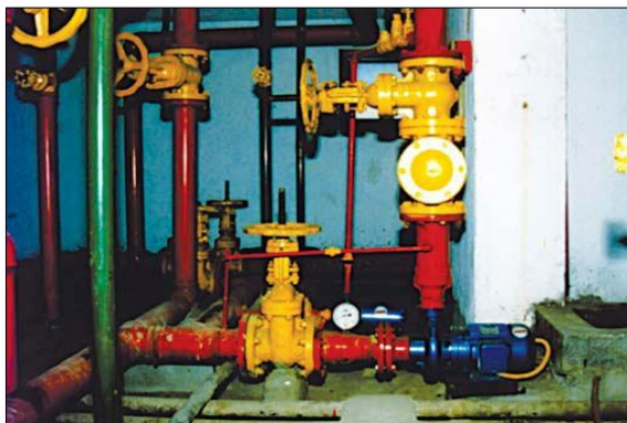
Figura 50 – Bomba de incêndio e acessórios hidráulicos
