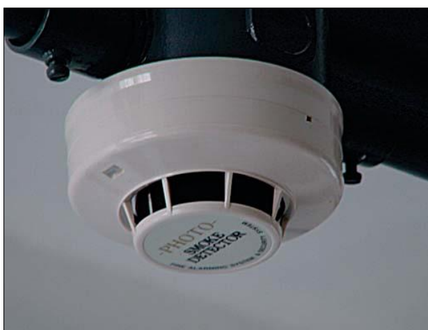
Figura 41 – Detector de incêndio
