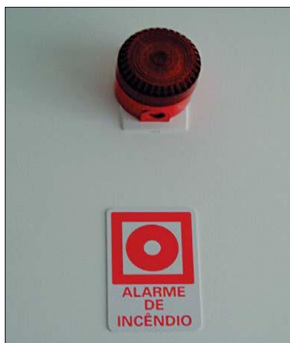
Figura 43 – Detalhe de sirene
