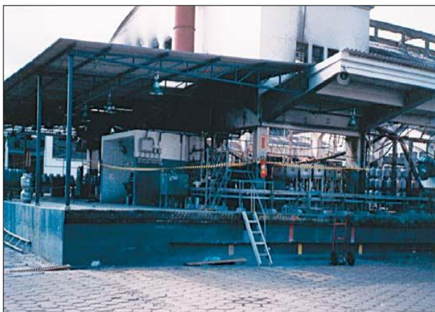
Figura 7: Isolamento do local sinistrado
