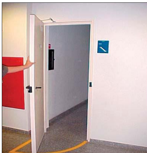
Figura 36 – PCF em corredor
