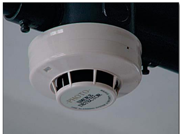
Figura 41 – Detector de incêndio
