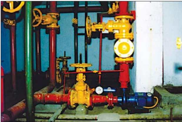
Figura 50 – Bomba de incêndio e acessórios hidráulicos
