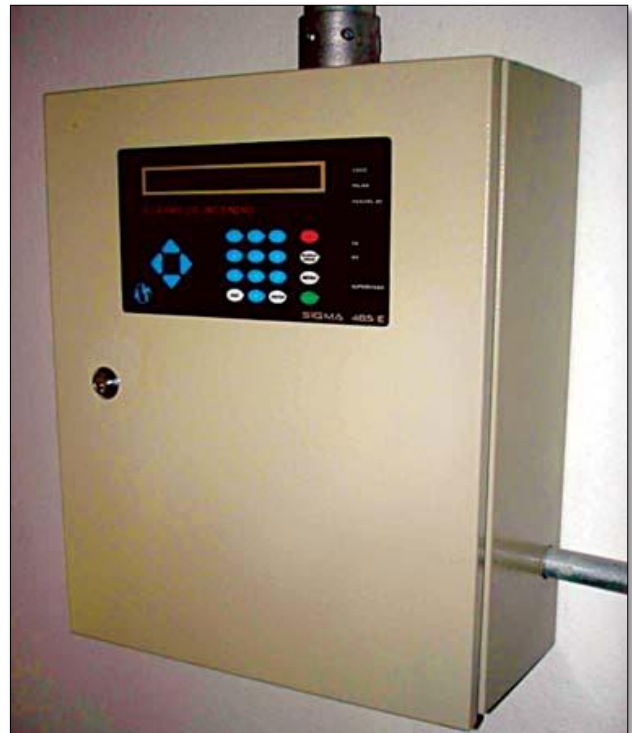
Figura 44 – Central de alarme
