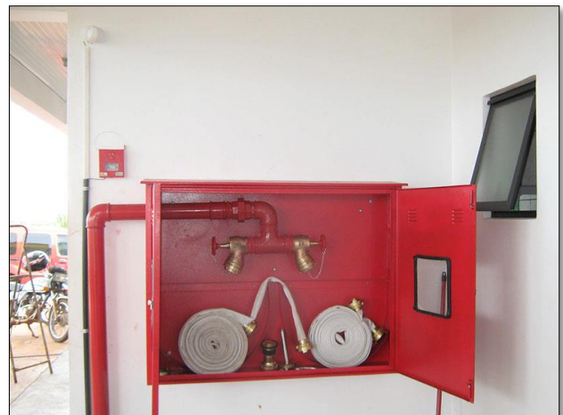
Figura 4: Sistema de hidrantes
